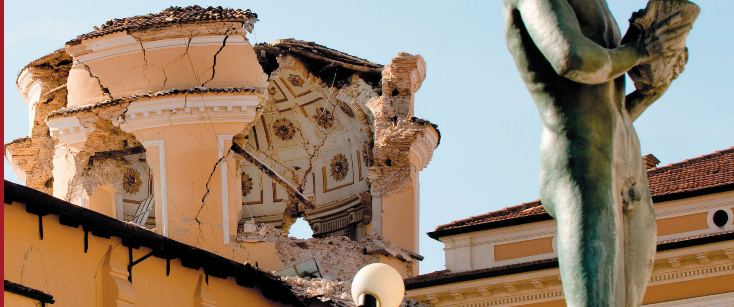
El domo de la Catedral, en el centro de L'Aquila, sufrió daños a causa del terremoto. AFP Fuente: https://www.elnuevodiario.com.ni/galerias/308/
