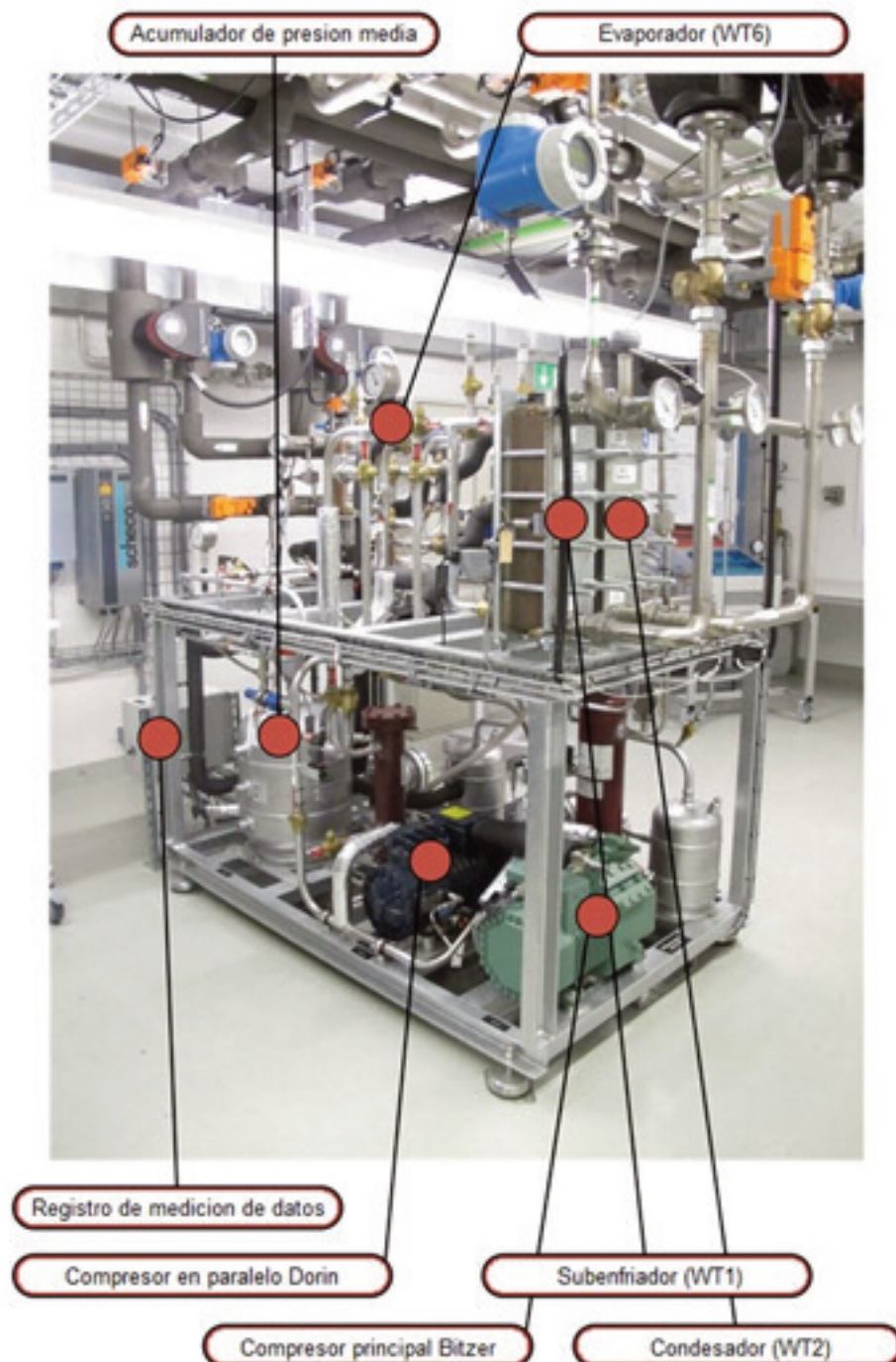
Figura N° 1. Vista general: máquina de refrigeración CO 2
