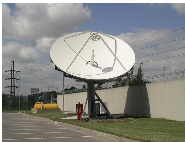
Figura2: Telepuerto para servicio de acceso a internet.
