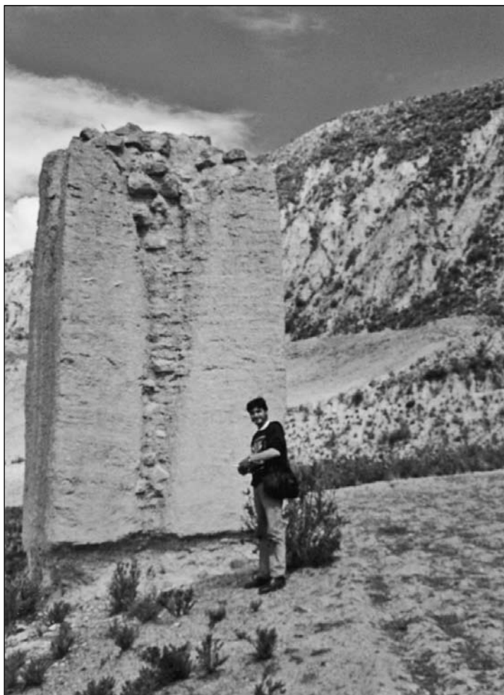
Figura 14b. Uypaca, ladera trasera de uno de los chullpares, con grieta formada por flujo de agua. Foto de M. Strecker (1998)
